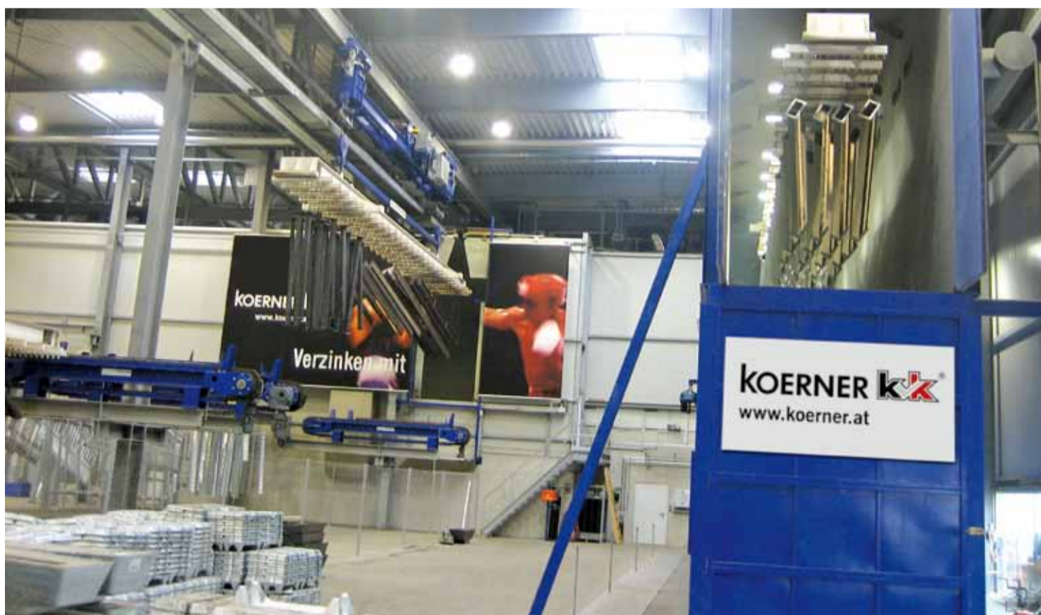
Die Verzinkungsanlage der OTN in Sinabelkirchen, Österreich, ist bezüglich Technik und Umweltstandards ein Musterbetrieb.
