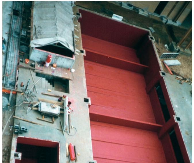
Auffangtasse für die Beizanlage einer Feuerverzinkerei
